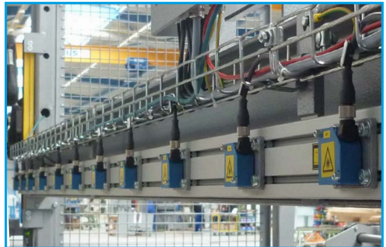
Fig. 4 : Les capteurs de mesure du système d'alimentation entièrement automatique AB920
