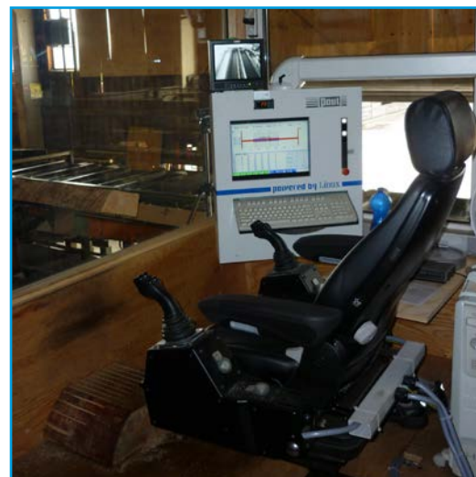
Fig. 2: Centre de contrôle dans une cabine séparée
